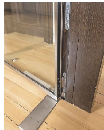
/ Schlanke Edelstahlprofile fassen die Ganzglas-Brandschutztüren ein.
