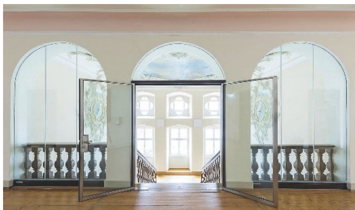
/ Mit den Brandschutztüren von Hoba konnte das ehemalige Kloster Sankt Peter in Brandabschnitte unterteilt und der Charakter des Gebäudes erhalten werden.
